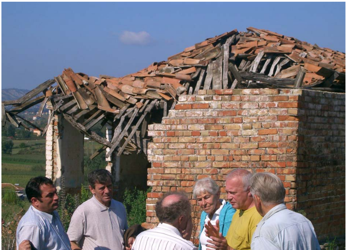
Das alte zerfallene Schulhaus vor dem Neubau.
