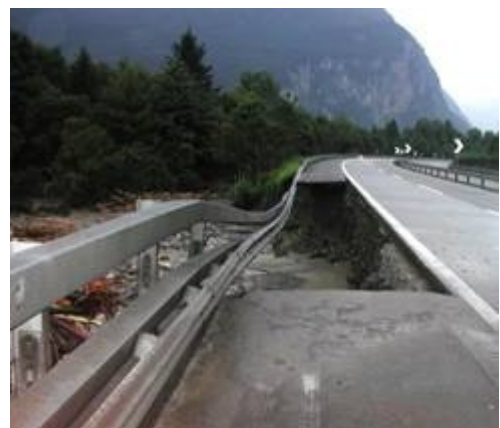
Foto 26: Zerstörter Pannestreifen der A2 (Kanton Uri, 23.08.2005,08:00)
