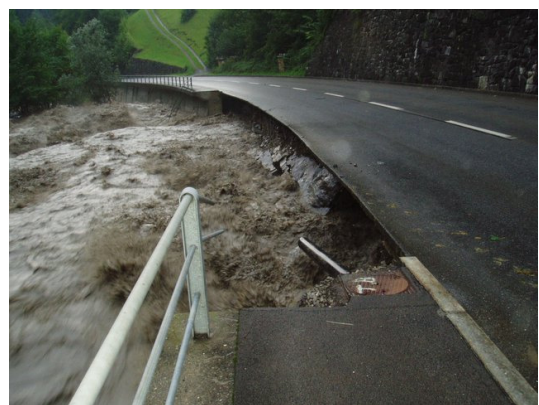
Foto 29; Zerstörte Klausenstrasse (Kanton Uri, 23.08.2005)
