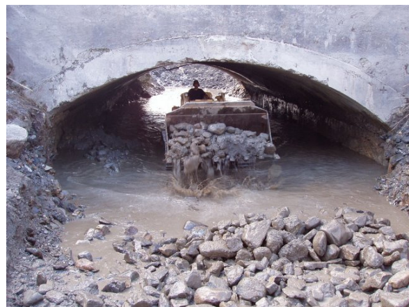
Foto 38; Räumung Unterführung Stille Reuss (Kanton Uri, 09.09.2005)
