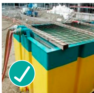
Absetzbecken mit Gitterrost, Einleitung vor der Prallwand/Tauchwand
