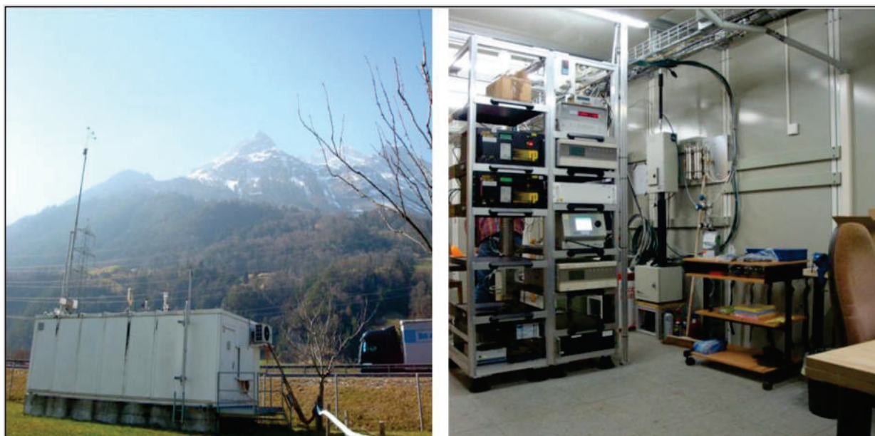
Abbildung 5: Messstation «A2 Uri» und deren Innenraum
