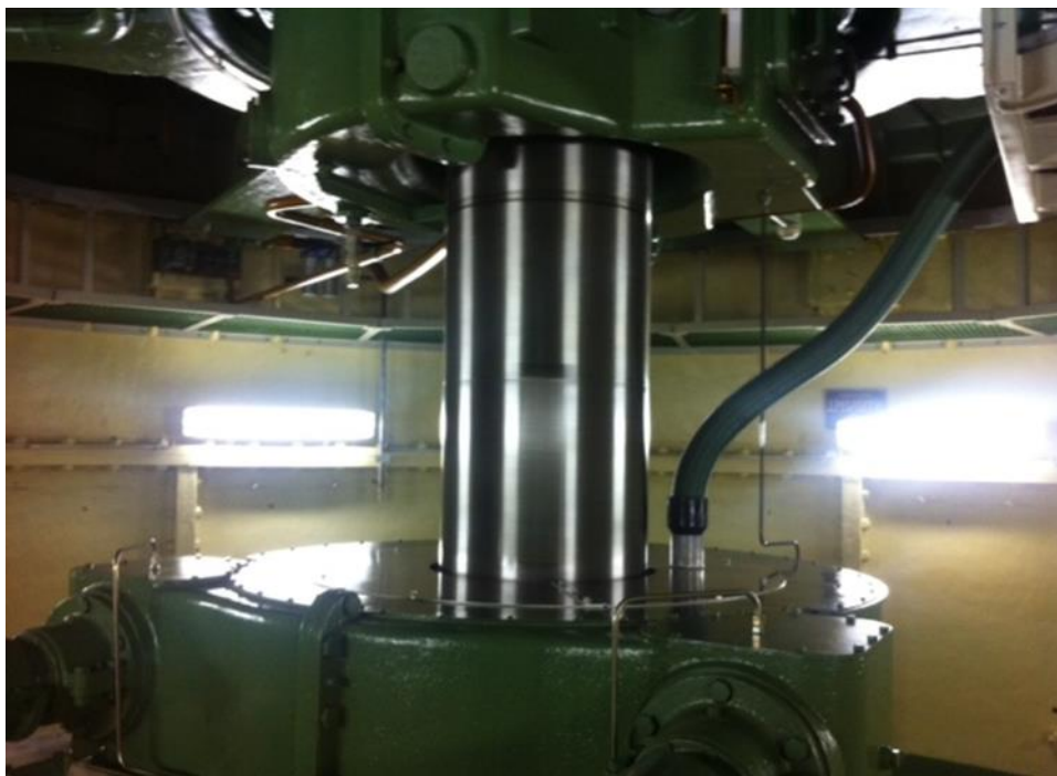
Abbildung 15-2: Welle zwischen Turbine und Generator
