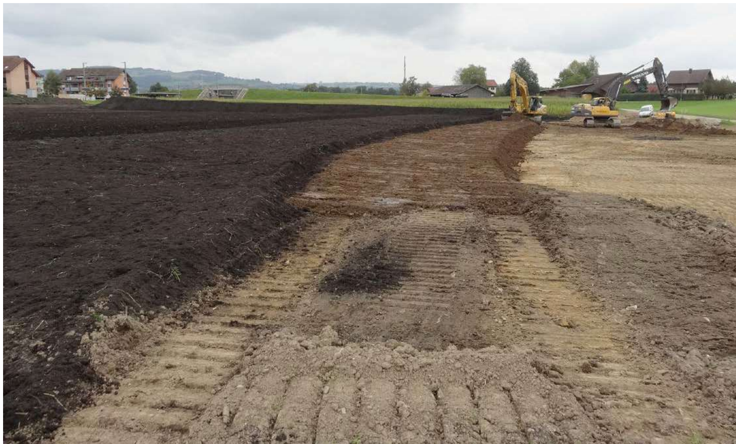
Korrektur Aufbau eines Bodens: Untergrund (rechts), Unterboden (Bildmitte) und Oberboden (dunkelbraun) werden aufeinandergeschichtet.
