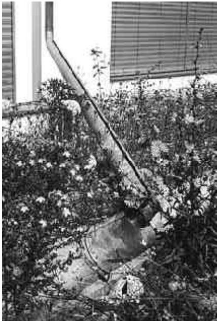
In der offenen Abflussrinne fließt das Dachwasser zum Biotop.
