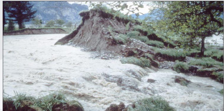
Dammbbruch beim Hochwasser 1987
